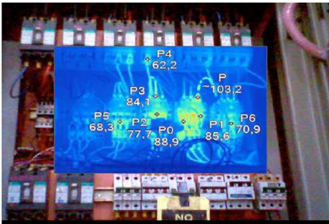
(A) PUNTOS SOBRECALENTADOS EN TABLERO
